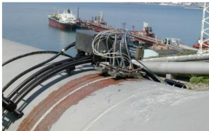
Рис. 13. Контроль системой Авгур нефтепровода.
