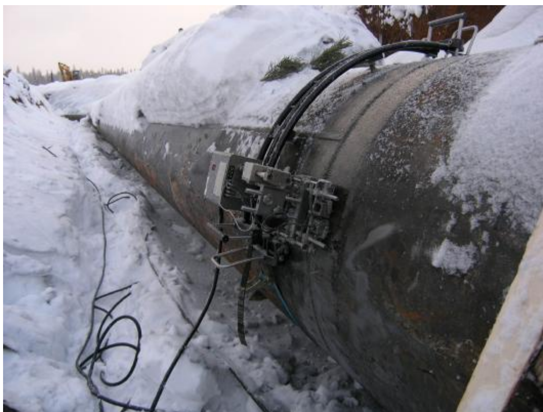
Регистрация данных на трубопроводе Ду 1000
